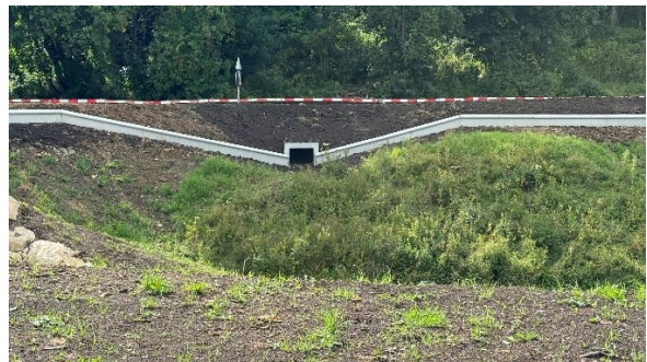
Une des deux nouveaux crapauducs avec les murs pour y guider les amphibiens
